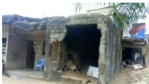
Photo 9. Un immeuble à moitié détruit mais habité au quartier PK 15 par le propriétaire qui n'a pas trouvé mieux ailleurs. © Petnga, fév. 2018
